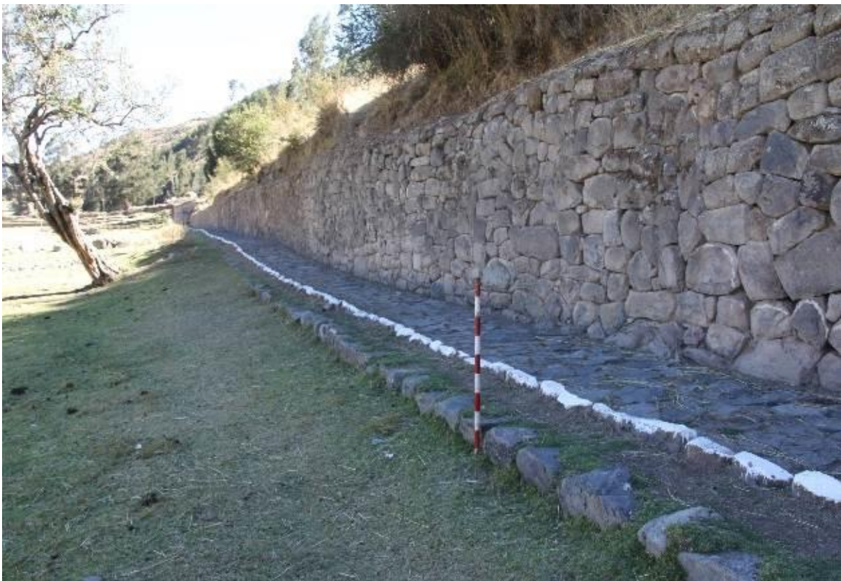
Foto 5.- Vista del muro de contención del cerro Amaruccasa. Toma de Noreste a Suroeste (Fuente: Qhapaq Ñan).
